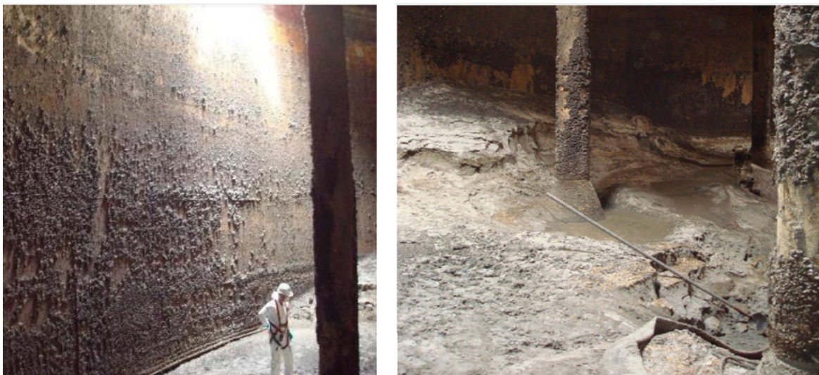
Imagen 2 Incrustaciones de estruvita dentro de un digestor anaeróbico, PTAR de Saskatoon (Canadá)
