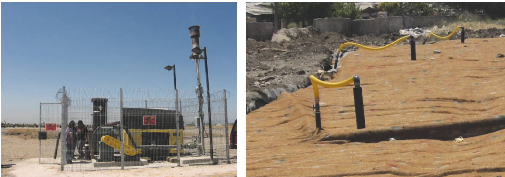
Imagen A.37 Ex vertedero Lo Errázuriz: planta y sistemas para quema de biogás
