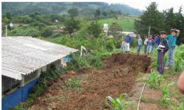
FOTOGRAFÍA 10 ESCUELA DEL BARRIO EL CHILE, AFECTADA POR EL TALUD DE TIERRA QUE CEDIÓ ANTE LA SATURACIÓN DE AGUA
