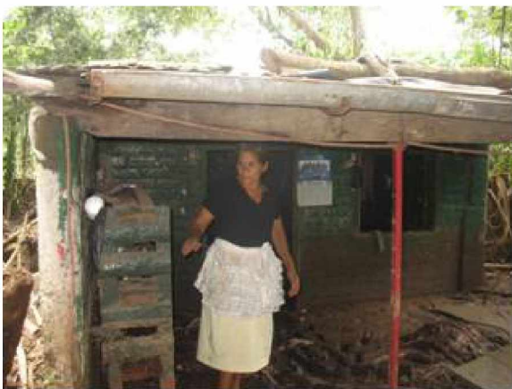
FOTOGRAFÍA 24 VIVIENDA AFECTADA CON DAÑOS PARCIALES DEL MUNICIPIO DE JUAYUA, DEPARTAMENTO DE SONSONATE
