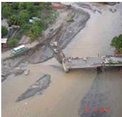
FOTOGRAFÍA 4 RÍO HUIZA, LA LIBERTAD, NUEVAMENTE COLAPSADO POR ÁGATHA
