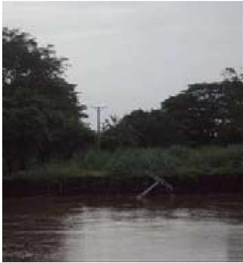
FOTO 39 DAÑOS EN LA TRANSMISIÓN
