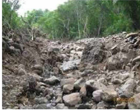
FOTOGRAFÍA 9 CAUCE DE LA QUEBRADA TIERRA BLANCA CON MATERIAL ROCOSO DESPRENDIDO
