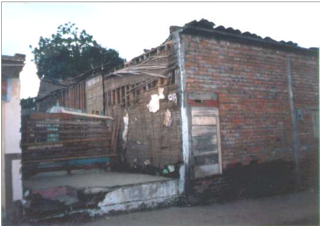
Tipos de afectación en construcciones diversas en Armenia
